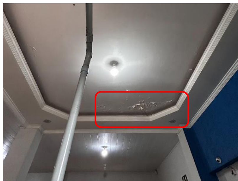
Figura 4 - Infiltração teto lavanderia
